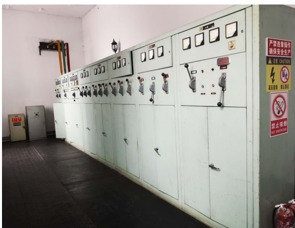
二水厂变电所低压开关柜
