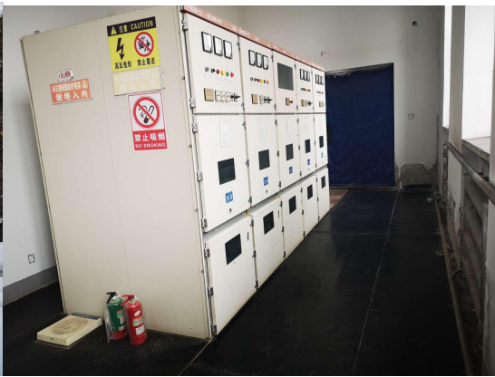
二水厂变电所高压柜
